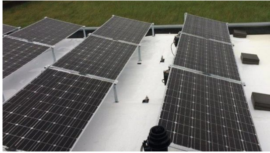
Abbildung 16: Pilotinstallation II; Untergrund weiße Dachbahn mit 80 % Albedo, Reihenabstand 2,5 m, Montagehöhe 30 cm
