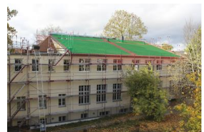
Genehmigt durch das Denkmalamt: Die Dachflächen dürfen mit effizienten PVT-Modulen belegt werden (in der Simulation grün eingefärbt). Foto: John-A. Keiler / Evelin Haase, Senckenberg Weimar
